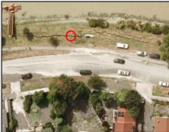
(d) Severe Lateral Spreading
