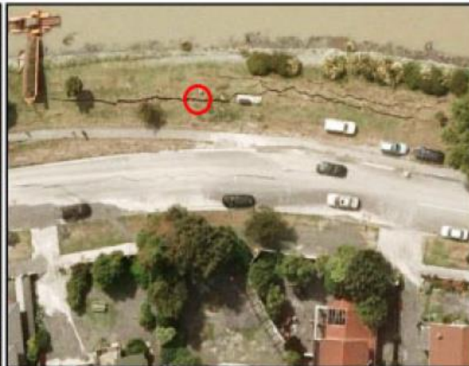
(d) Severe Lateral Spreading
